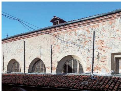
I cavi elettrici che portano la corrente in casa parrocchiale
