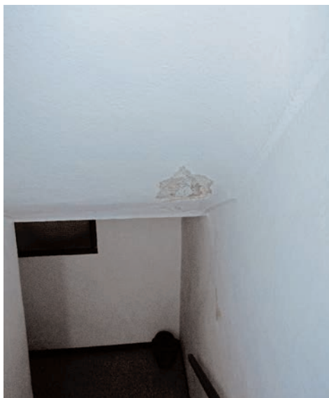
Le macchie lasciate sul muro dall'acqua che esce dai tubi marci (secondo tempo)
