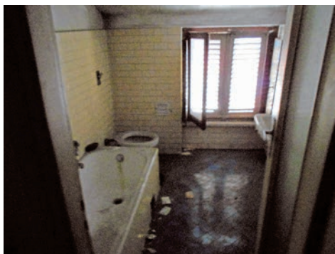
La situazione del bagno al secondo piano
