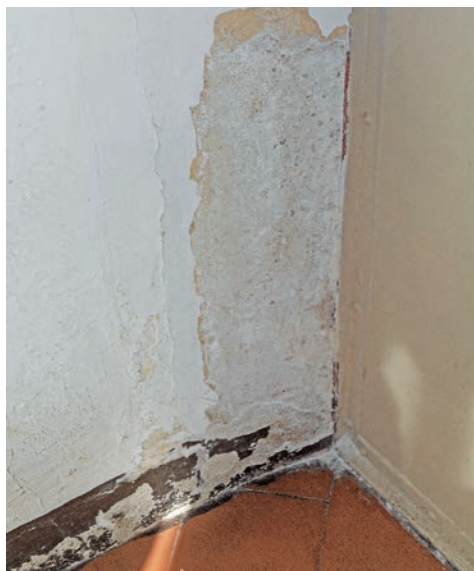
Le macchie lasciate sul muro dall'acqua che esce dai tubi marci (primo tempo)
