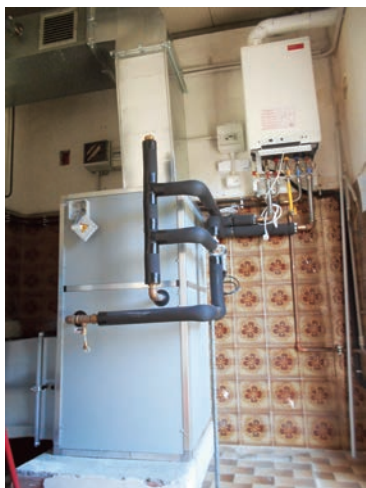
La nuova caldaia della Casetta Coda con tanto di impianto di ventilazione
